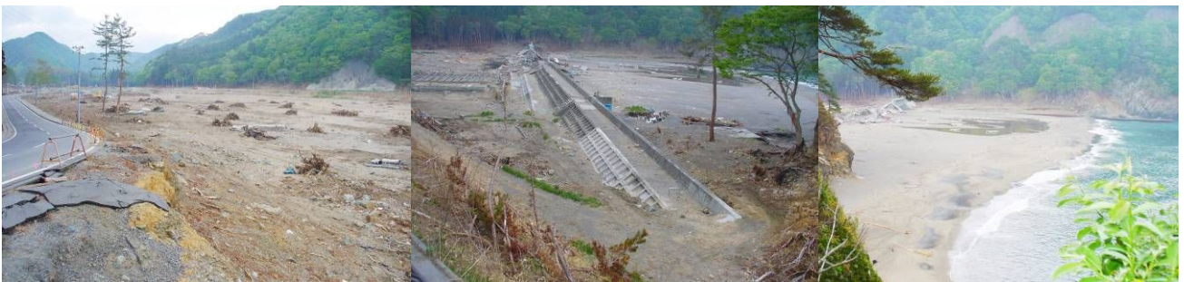
(写真) 左：明戸キャンプ場があった松林／中央：損壊した堤防／右：明戸浜
